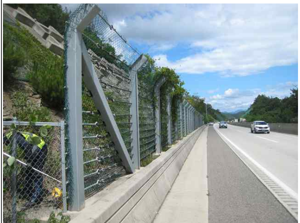
도로부, 낙석방지울타리 전경
