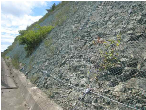
3단 풍화구간, 낙석방지망 전경
